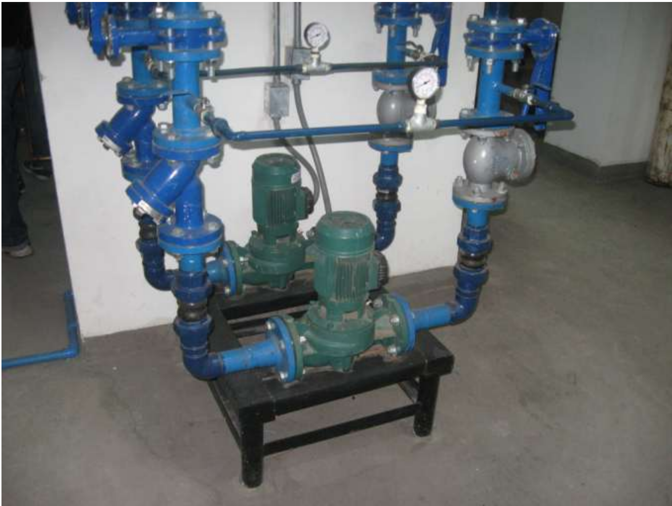
Dos bombas recirculadoras en paralelo (mantención)
