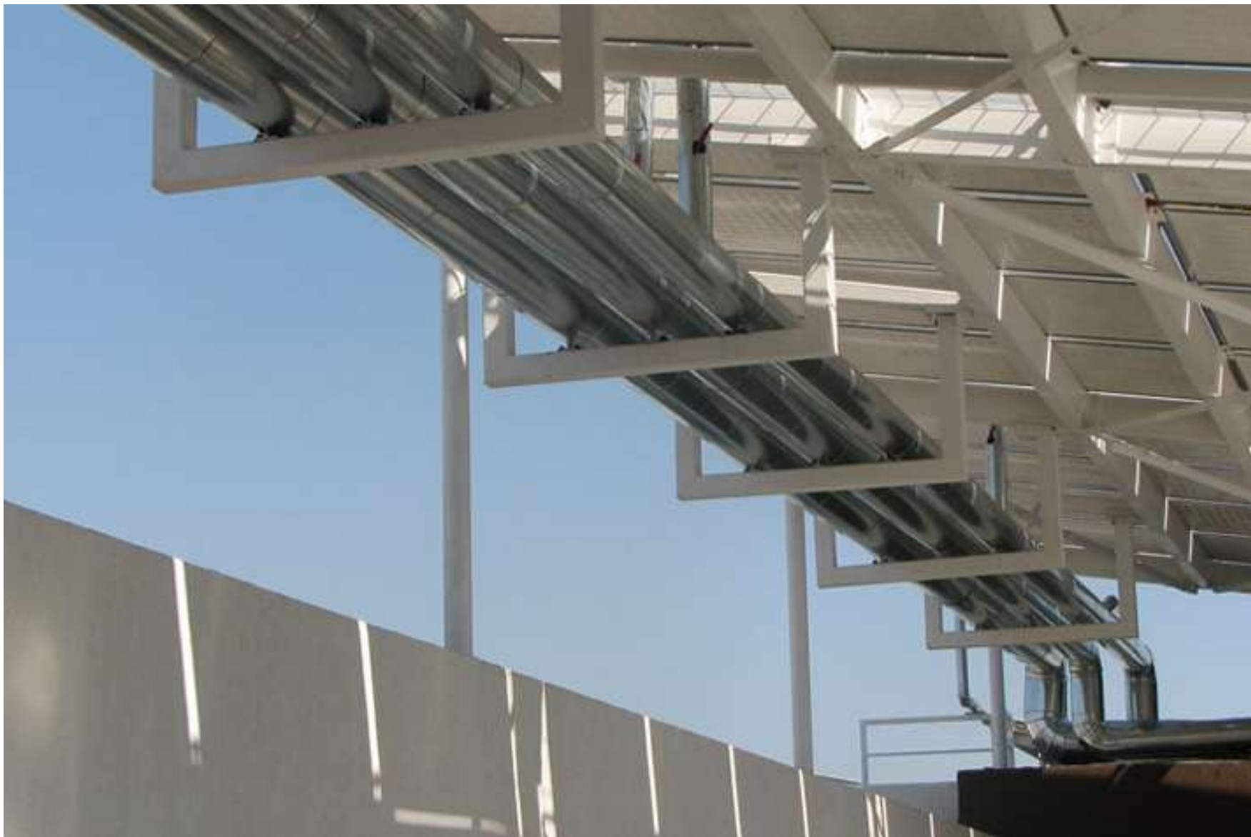
Correcta Aislación de tuberías en el exterior.
