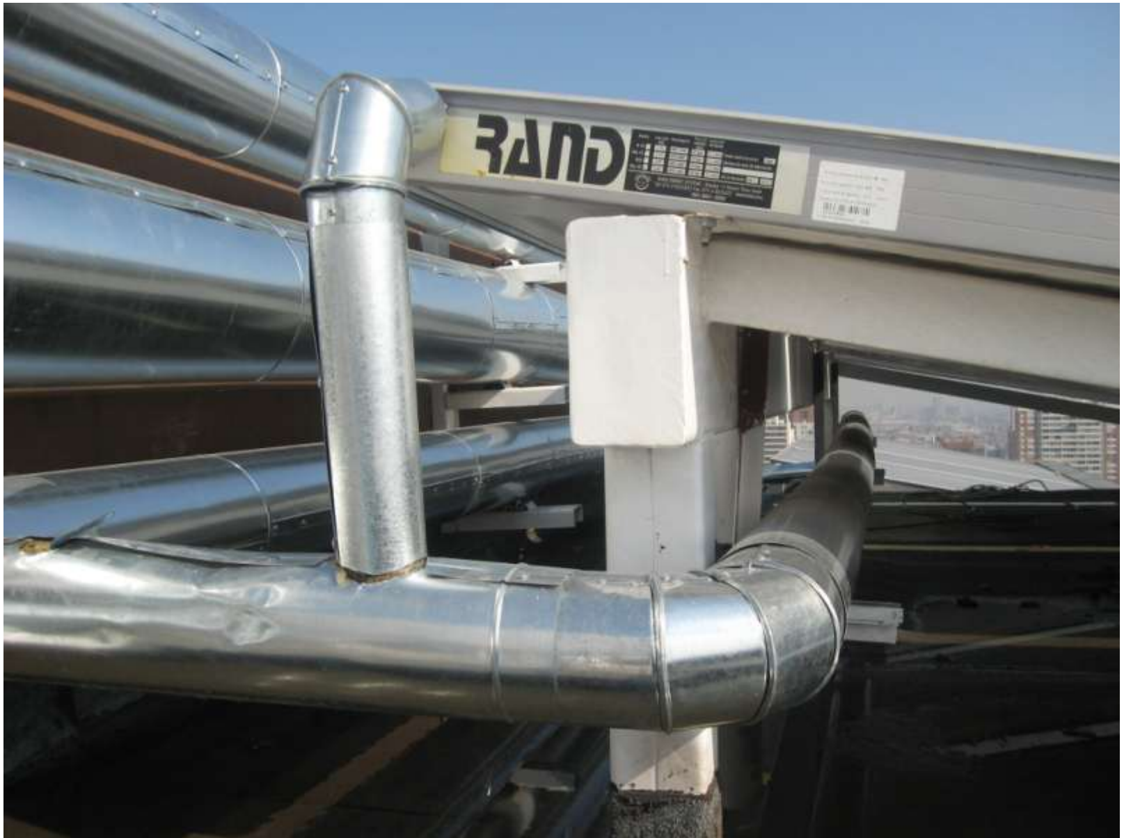
Correcta Aislación de tuberías en el exterior.
