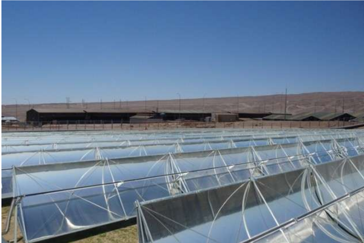
Planta Termosolar El Tesoro: 55% aporte solar, del orden de 10 MW térmico
