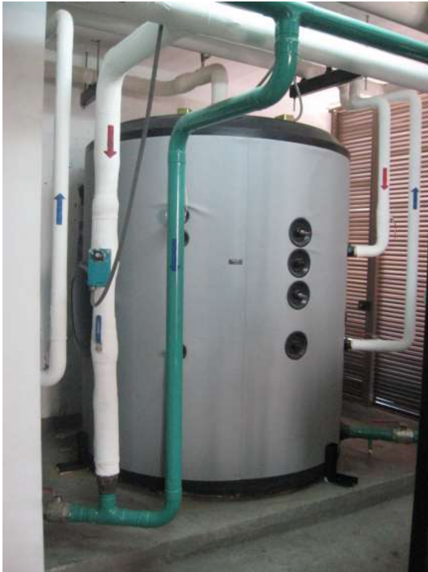
Acumulador Solar (4.000 lts)
