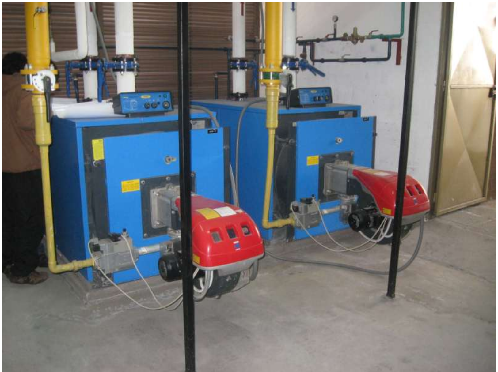
Sistemas de apoyo convencional (2 calderas)
